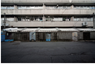
15-A. 中央卸売市場第一市場 関連 10・11号棟 南壁面
